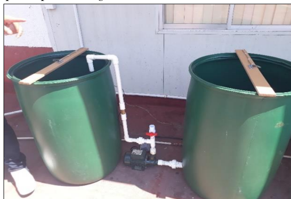
Figura 4. Descripción gráfica de los contenedores de agua y la bomba de rebombeo de agua
